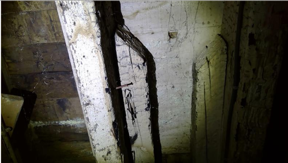
Cave n°1(Sous-sol) : Plafond (Plâtre et plancher bois - Peinture)
